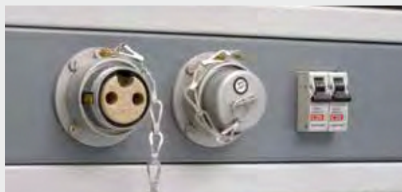
Metal Clad Socket
